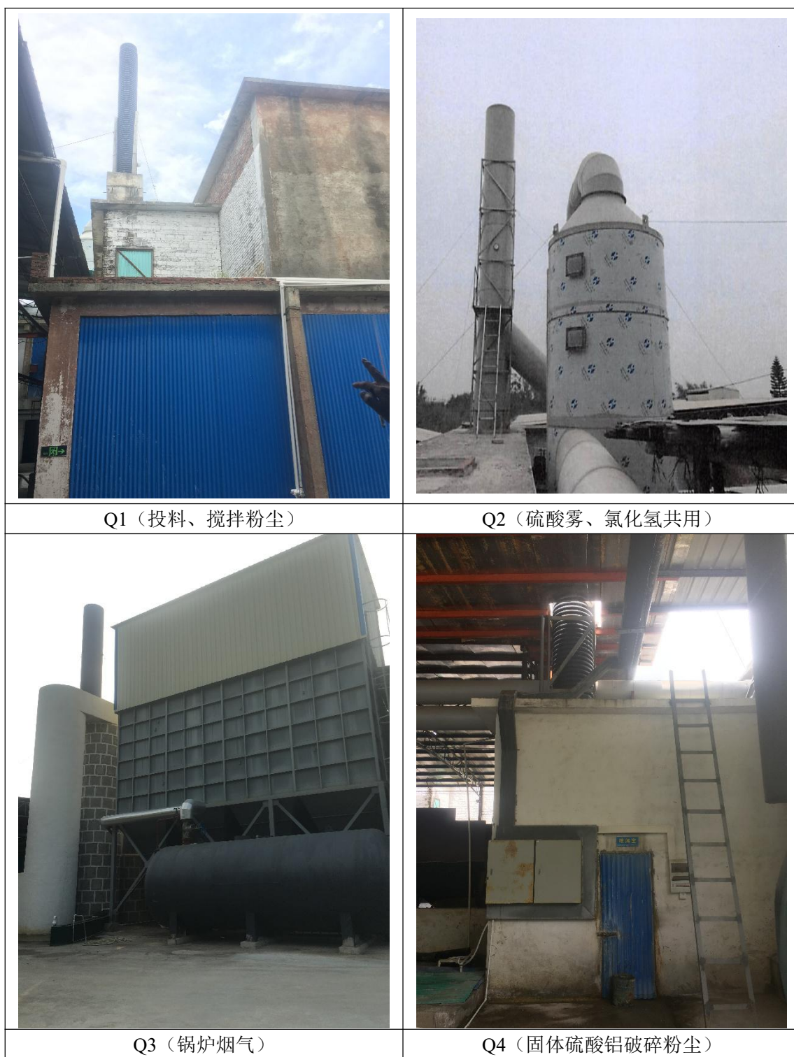
图 3.7-1 有组织废气排放口
